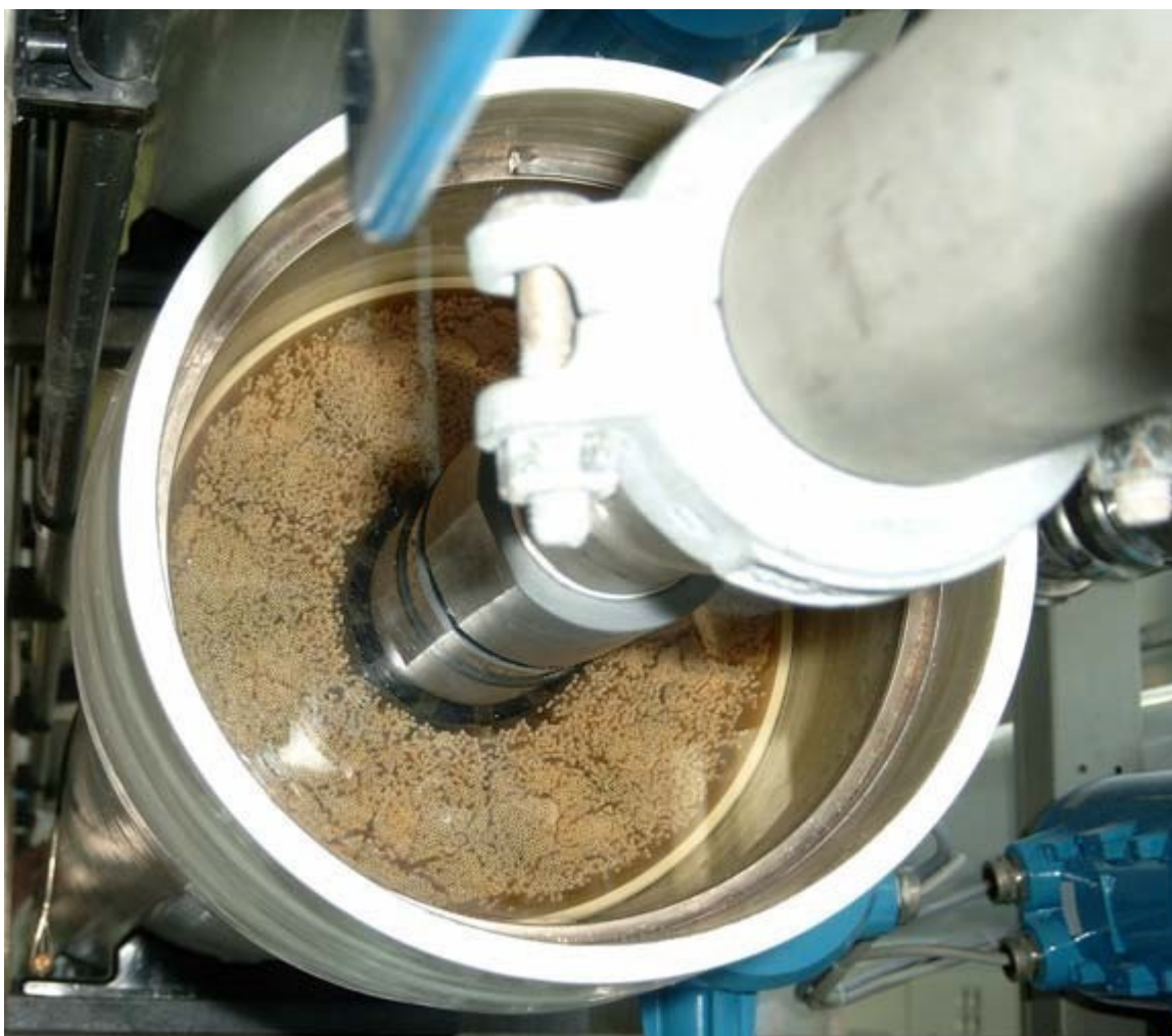
Figur 14.4. Ultrafiltreringsanlæg med hulfibermembraner til behandling af svømmebadsvand
